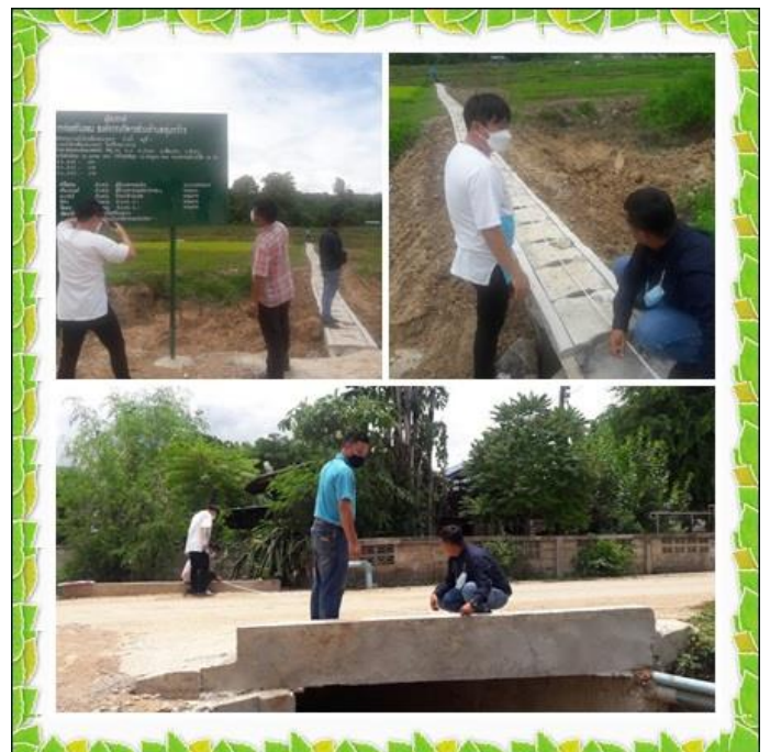
โครงการก่อสร้างรางระบายน้ำ คำเหมืองทุ่งนาหมาก หมู่ 1
